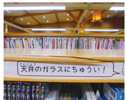
落下した防煙垂れ壁による書架の傷と注意を促す掲示
