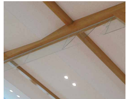
天井の防煙垂れ壁が破損 天井が高いため普段は視界に入らない
