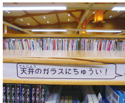
落下した防煙垂れ壁による書架の傷と注意を促す掲示
