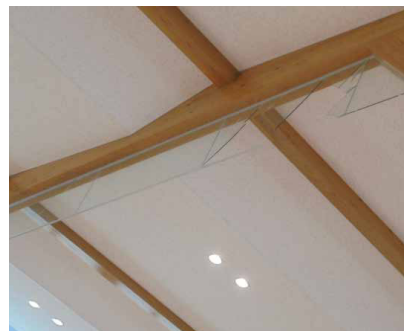
天井の防煙垂れ壁が破損 天井が高いため普段は視界に入らない
